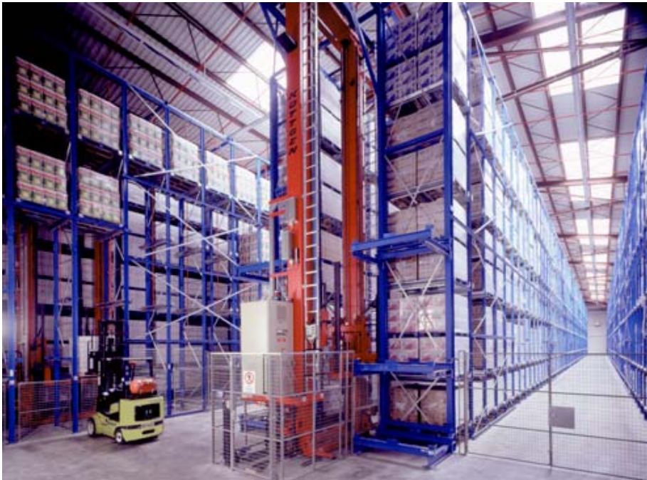
Gesamtansicht des 3gassigen automatischen Hochregallagers (Foto Köttgen)
